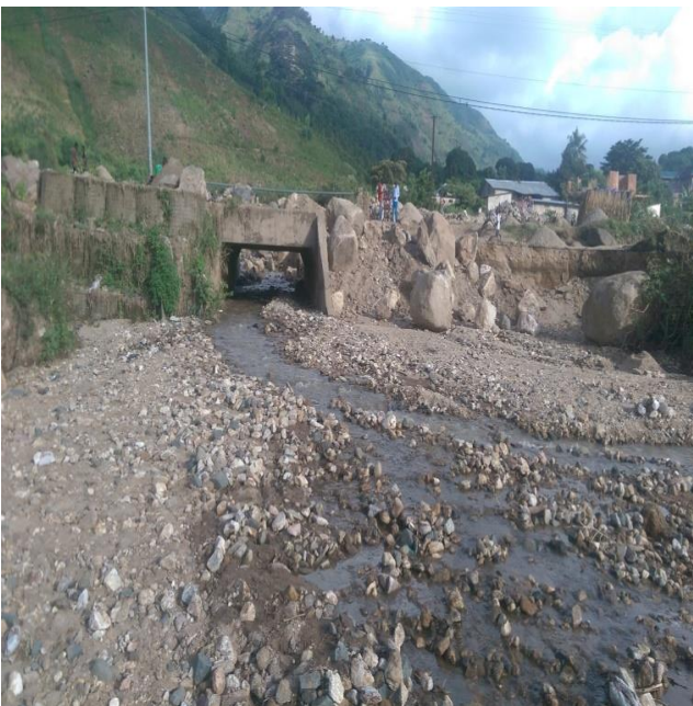
Fig. 3 Torrent Kamongola (03 ° 25'48"S, 29 ° 07'51"E. 796m)
